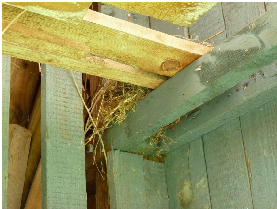
Abbildung 17: Vogelnest (Amsel) im Querbalkenbereich an / in der halboffenen Scheune (Schlitze in den Holzwänden)
