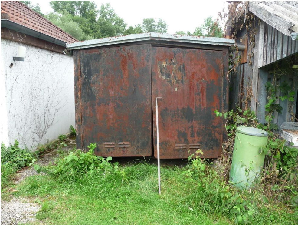
Abbildung 19: Metallgarage mit ca. 30 -40 cm offenem Garagentürenbereich in Bodennähe
